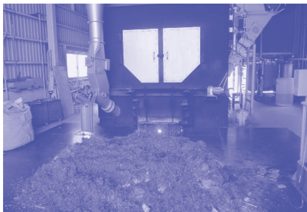
林業の振興と一体に木質エネルギーを活用。木材加工で出た木屑を乾燥に利用（木材センター・宍粟市）
